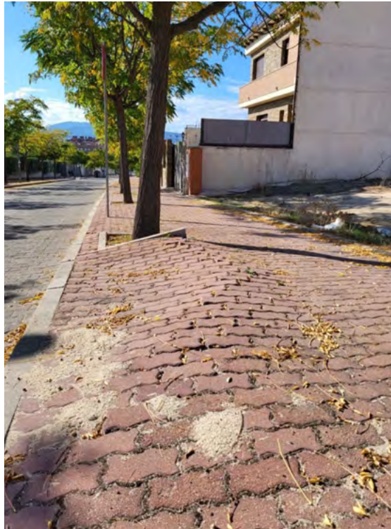
Imagen de los deterioros del pavimento provocados por las raíces del arbolado de alineación.
