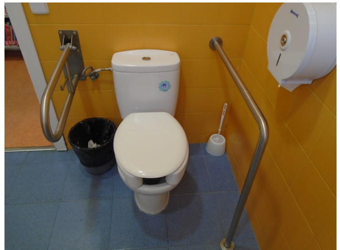
Aseo común adaptado
