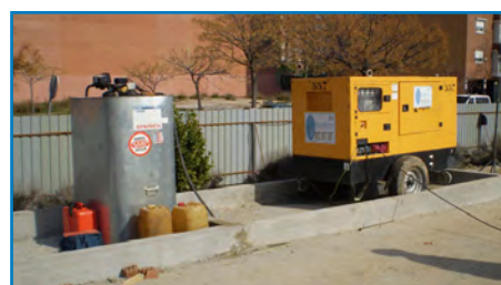
Gráfico 48. Detalle de zona habilitada para ubicación de grupo electrógeno y depósito de combustible
