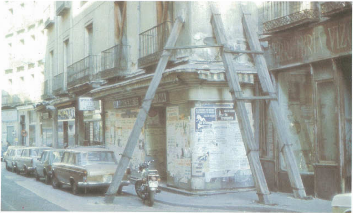
El centro de la ciudad sufre deterioros; a veces provocados por los propietarios de los inmuebles para buscar mayor rentabilidad a sus casas, vendiéndolas a empresas constructoras.
