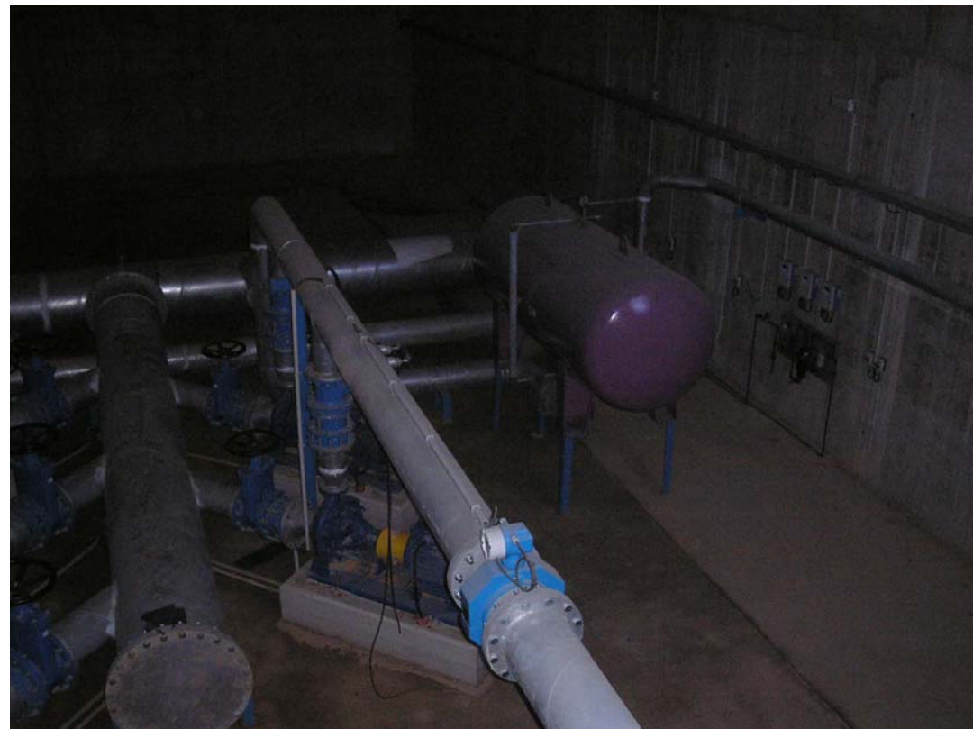
2.- Estación de bombeo depósito de Sanchinarro
