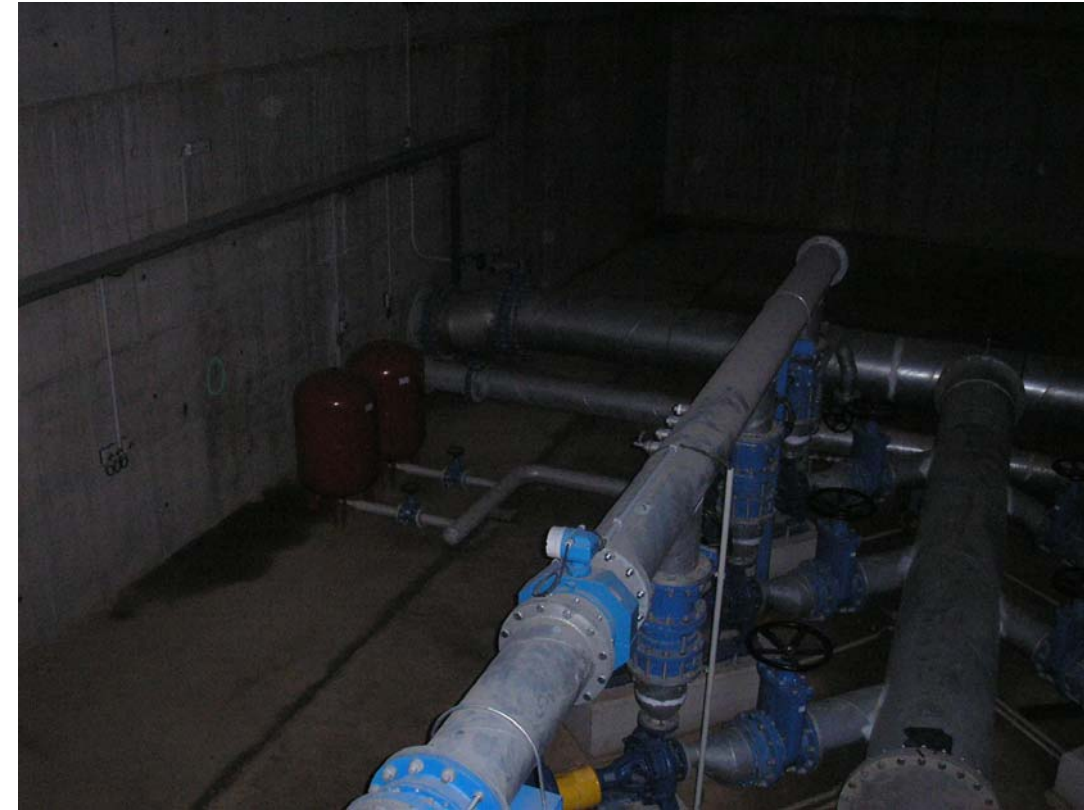
3.- Estación de bombeo depósito de Sanchinarro
