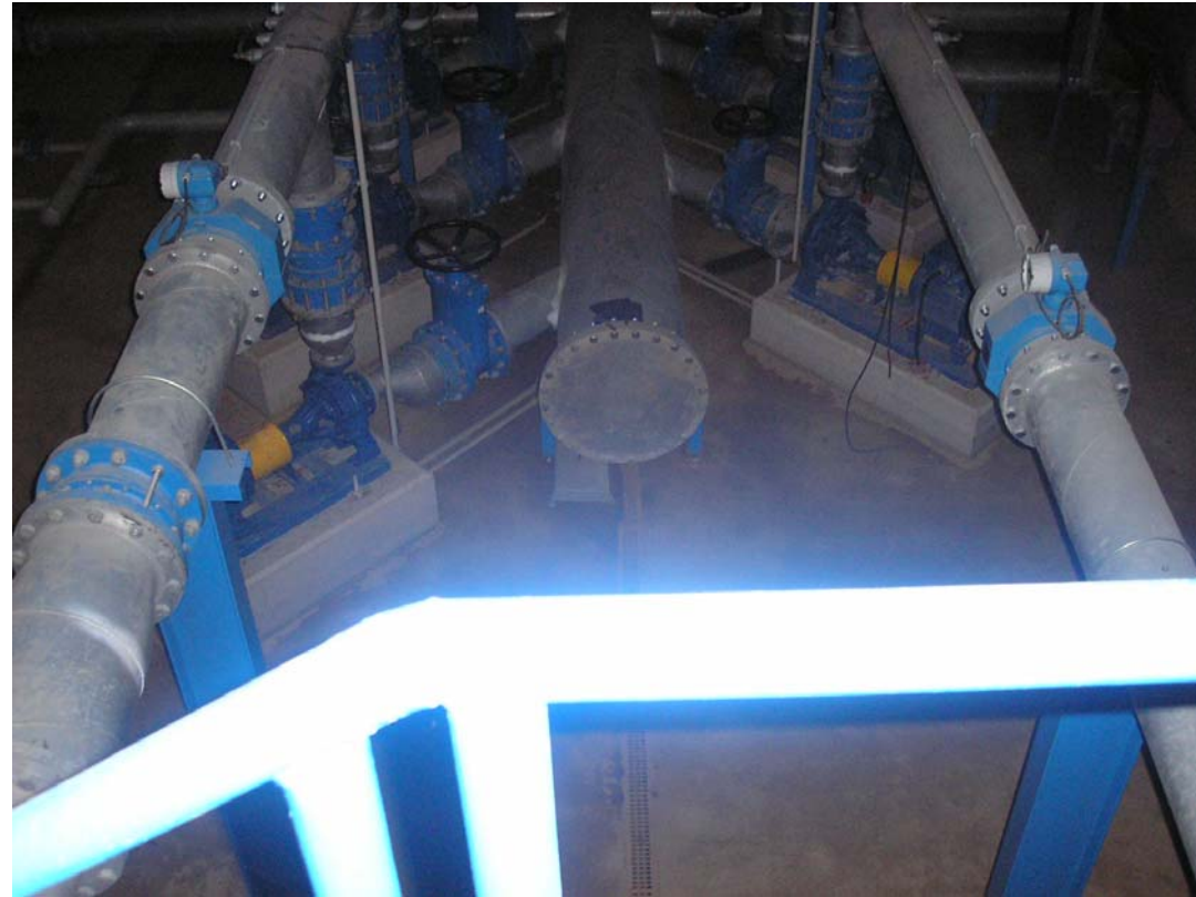
1.- Estación de bombeo depósito de Sanchinarro
