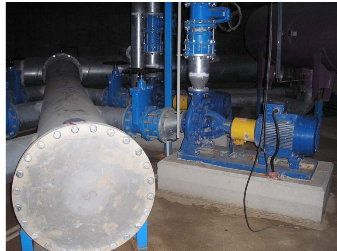
4.- Estación de bombeo depósito de Sanchinarro
