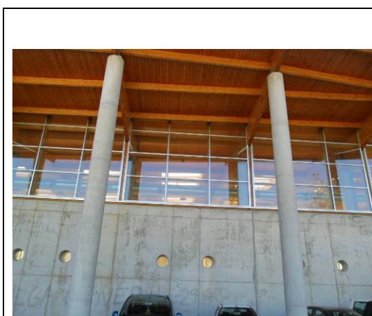
Carpintería exterior Piscina
