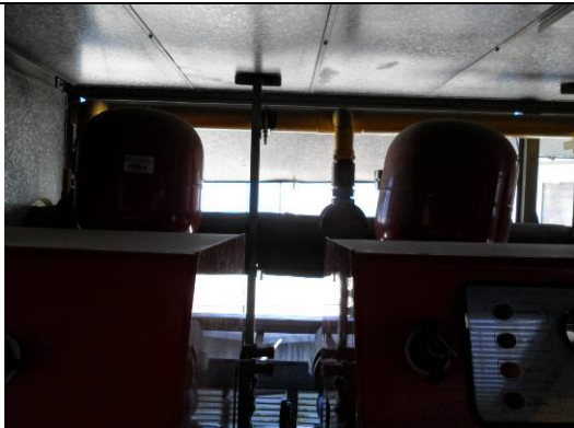
Sala de calderas
