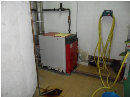
Sala calderas Pabellón – Caldera ACS
