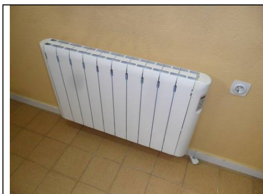
Radiadores Eléctricos. Oficinas
