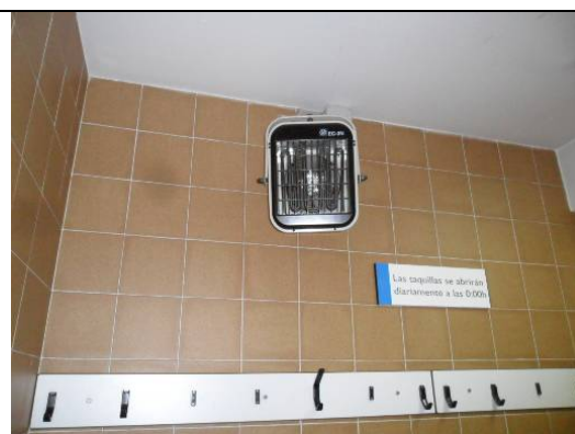
Aerothermo Eléctrico. Vestuarios Públicos
