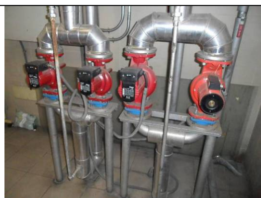
Bombas de calefacción y ACS
