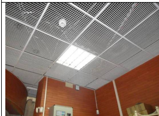
Iluminación oficina control
